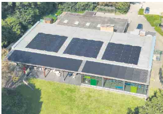
Photovoltaik auf dem Hallenbaddach
